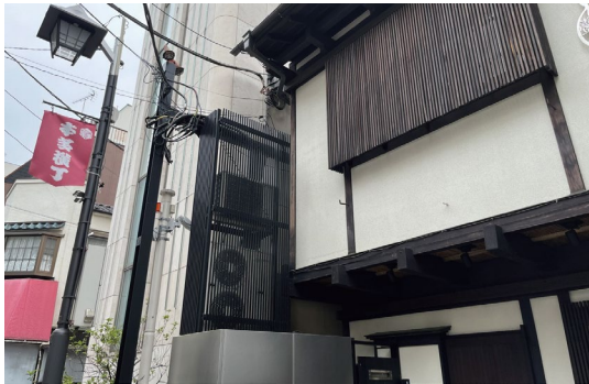
設備機器の修景／グレーの金属ルーバー
